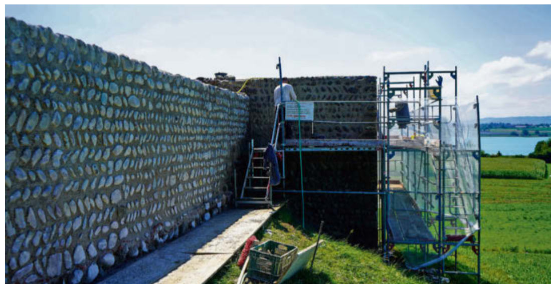
Ein Arbeitsort mit Ausblick: Die Mauer auf der linken Seite wurde bereits fertig saniert.
