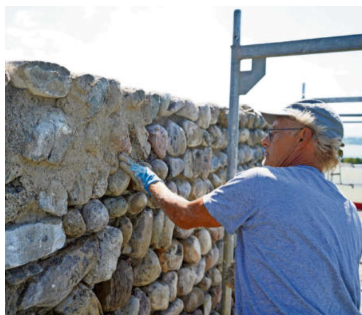
Alle losen Steine werden wieder in die Mauer eingepasst und mit neuem Mörtel eingeschlossen.
